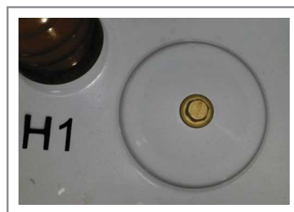
FIGURA 12: Tampa de inspeção
